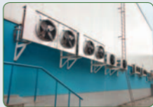
The outside view of Linxtelecom's Moscow DC/ Внешний вид ЦОД Linxtelecom в Москве
